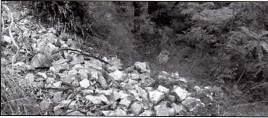
Material esllavissat procedent del rebaix de les obres dels xalets.
